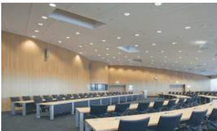
Rathaus Leverkusen BER Metall-V Akustikplatten Oberfläche BER Strukturlack weiß
